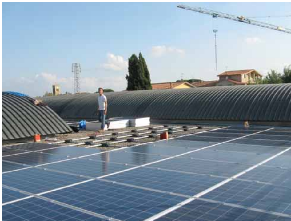
Pannelli fotovoltaici sul tetto della Scuola Primaria di Cascine di Buti
